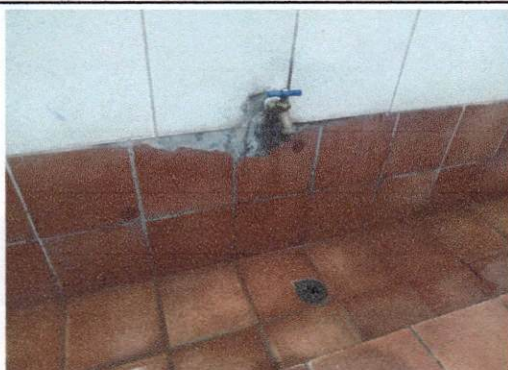
Foto 3: PILETA PARA LAVADO DE MANOS
