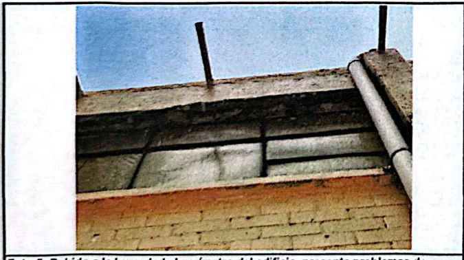
Foto 5: Debido a la humedad el perímetro del edificio, presenta problemas de desprendimiento de la capa de concreto que reviste las varillas de acero corrugado.
