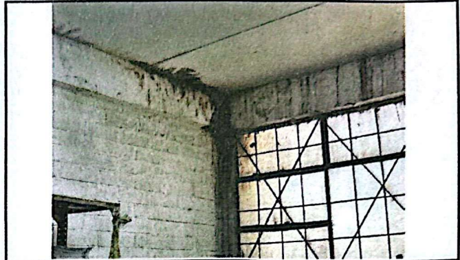
Foto 2: Se aprecian los problemas de filtración dentro de las aulas, el cuál se agrava en época de lluvia.
