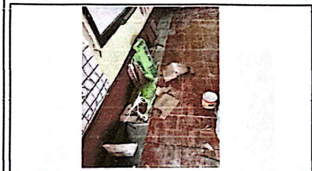
Foto 9: Se avanza con la colocación de piso en los salones correspondientes, por lo que se verifica que el pegado sea apropiado y que tenga la nivelación esperada.
