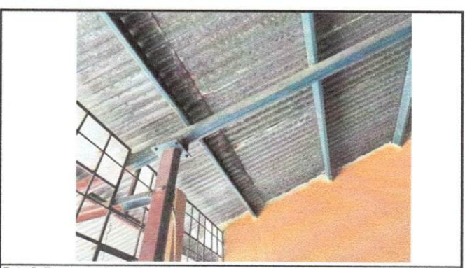
Foto 5: Es necesario realizar el cambio de techo para evitar los problemas de filtración que afectan la salud de los niños por la humedad que se genera.
