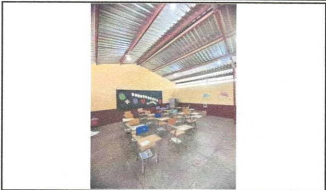
Foto 2: Salón piso de cemento, el cual cuenta con Techo en buenas condiciones, por lo que se le da prioridad a la colocación de piso.
