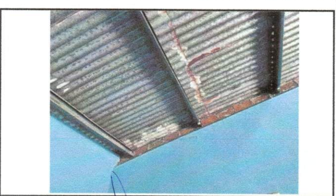
Foto 6: Al igual que la lámina, la estructura metálica de soporte para el techo, presenta problemas de oxidación, por lo que se deberá realizar el mantenimiento correspondiente.
