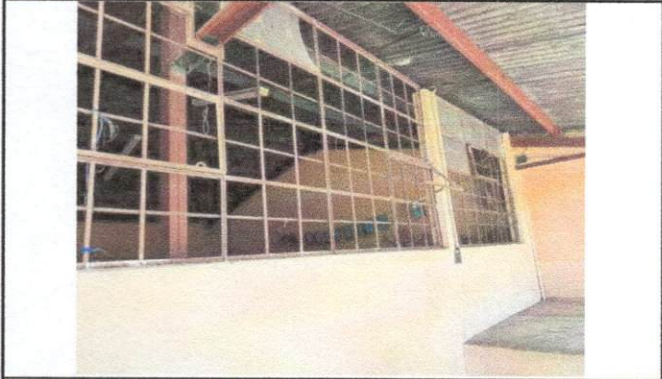
Foto 7: Se realizará el mantenimiento de las ventanas, lijado y pintura+ suministro e instalación de vidrios.
