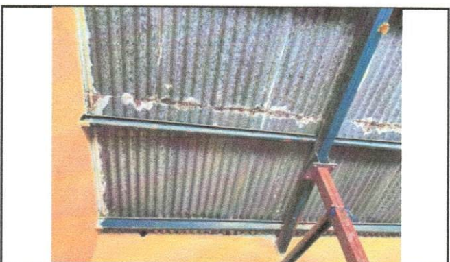
Foto 4: En la parte interna de los salones se puede percibir las manchas y el óxido producto de la filtración de agua que existe en épocas de lluvia.
