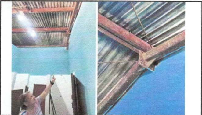
Foto 9: Se puede apreciar la cantidad de óxido que presenta la estructura del techo en el área de baños, debido a los problemas de filtración y falta de mantenimiento.
