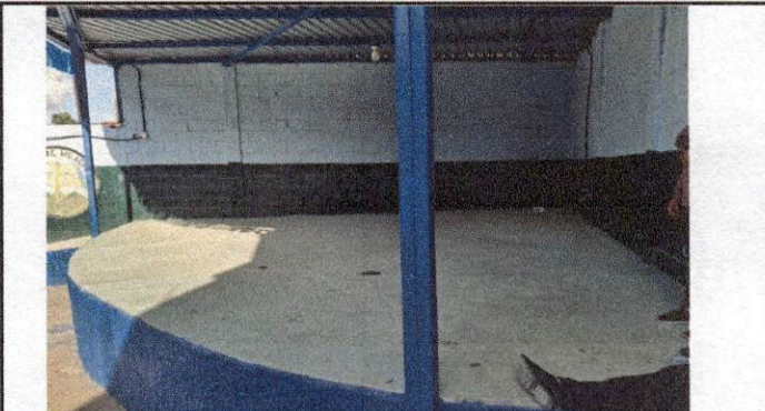
Foto 4: Cernido de suelo y pintura.
