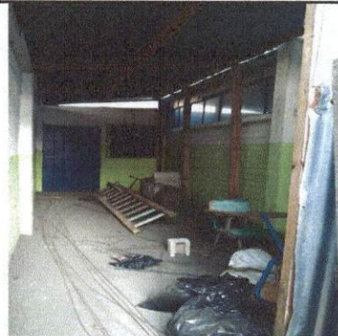
Foto 2: Limpieza de espacio, techo de parales de madera y suelo desnivelado
