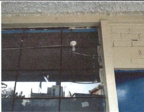
Foto 3: Focos mal instalados en los pasillos
