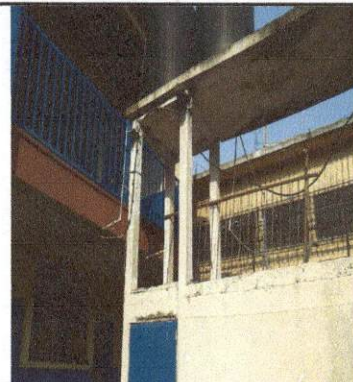
Foto 2: Cableado colgando en diferentes areas.
