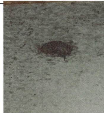
Foto 6: Aulas sin plafoneras y sin focos.
