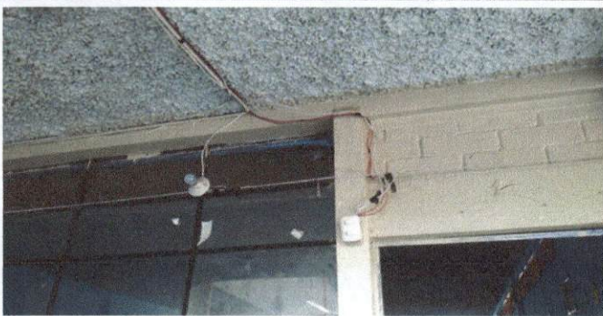
Foto 5: Unión de cableado mal instalado
