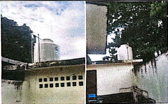
Foto 9: Suministro e instalación de 2 tinacos, para el abastecimiento de los servicios sanitarios.
