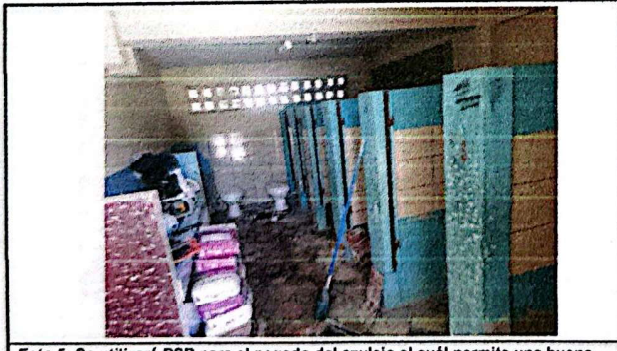
Foto 5: Se utilizará PSP para el pegado del azulejo el cuál permite una buena adherencia de los azulejos en los muros.
