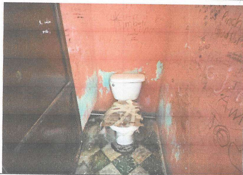
Foto 3: Baños Niñas, en mal estado es necesario sustituir sanitario y colocar azulejo y aplicación de pintura en muros
