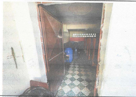
Foto 6, Baños Niñas, es necesario dar mantenimiento a puerta de ingreso
