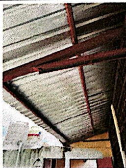
Foto 5: Lámina en voladizo de pasillo.
