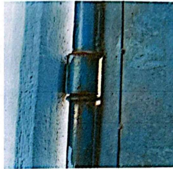
Foto 2: ÁREA DE PORTONES, PORTÓN PEQUEÑO, EL ÓXIDO INICIA EN LA BISAGRAS Y OTRAS PARTES DEL PORTÓN.
