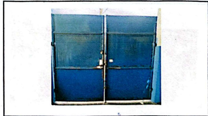
Foto 6: ÁREA DE PORTONES, PORTÓN PEQUEÑO, SE DETERIORA POCO A POCO A CAUSA DEL ÓXIDO.
