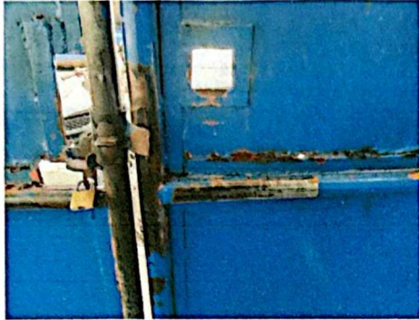
Foto 3: ÁREA DE PORTONES, PORTÓN PEQUEÑO, EL ÓXIDO IMPIDE QUE SE SE ABRA CON FACILIDAD.
