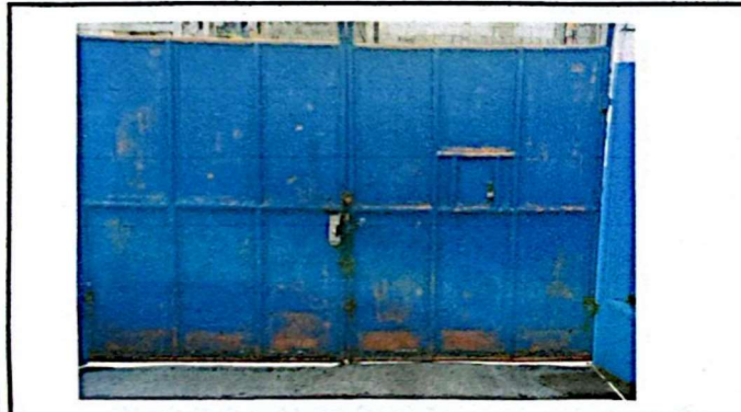
Foto 3: ÁREA DE PORTONES, PORTÓN GRANDE DIFÍCIL ACCESO; YA QUE SE TRABA EL MECANISMO PARA ABRIRLO.
