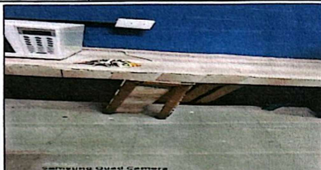
Foto 1: Reparación de 6 mts2 área de Cocina donde el azulejo esta en mal estado
