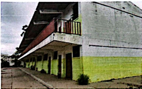
Foto 17: Pintura Interior Modulo 3 pared del area de las aulas son dos niveles por modulo.
