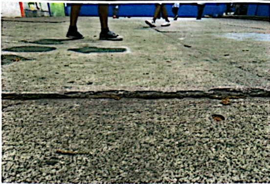
foto 1: Las grietas e irregulares han provocado accidentes donde los estudiantes han salido lesionados, estos hechos ocurridos durante receso y la clase de Educación física, motivo por el cual se realizarán
