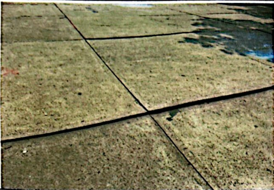
Foto 1: El pavimento de concreto en cancha presenta por el paso del tiempo elevaciones irregulares.
