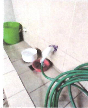
Foto 8: Los chorros presentan fuga.
