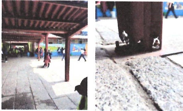
Foto 7: La estructura del techo que se encuentra en el área de pasillo, se encuentra deteriorada por lo que es necesario realizar la sustitución de las piezas en la parte inferior.
