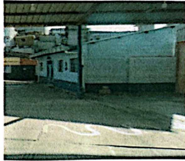
Foto 4: Mantenimiento de pintura de costaneras en escenario
