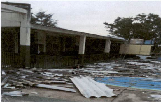
Foto 3: ripo de la lamina que se quito del techo.
