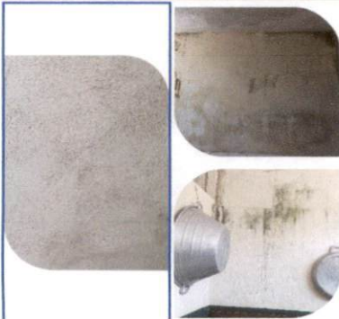
Foto 3: en cocina interna realizar curación de paredes para luego realizar el repello y pintura de la misma
