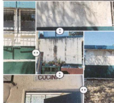
Foto 2: Area de cocina externa impermeabilización de terraza, paredes laterales, ya que por la humedad se esta deteriorando las paredes de block manteniendose con humedad y moho
