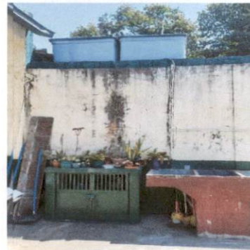
Foto 4: realizar columnas y terraza para separar los tinacos del area de terraza de cocina ya que estos estan provocando tambien la humedad en la misma. Y servira de techado en el area de pila en donde las mamás
