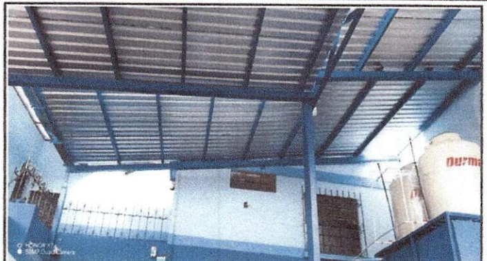
Foto 2: Se realizó la instalación de canales como también de luz para tener una mejor visión.
