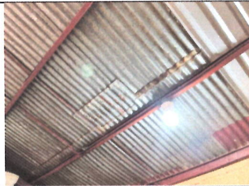
Foto 3: Para dar una solución temporal a los problemas de filtración se han colocado diferentes refuerzos de lámina.
