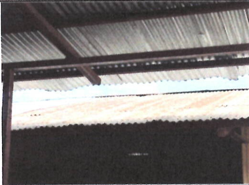
Foto1: . Vista exterior del techo de lámina en aulas, oxidación en un 85% de la superficie, generando filtraciones.
