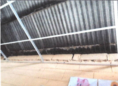
Foto 7: Problemas de filtración en el Aula A, de los niños de párvulos
