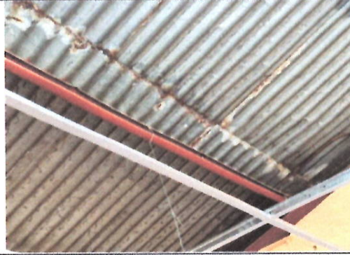
Foto 2: Se puede apreciar los puntos en los cuales es mas evidente el problema de filtración en épocas de lluvia.
