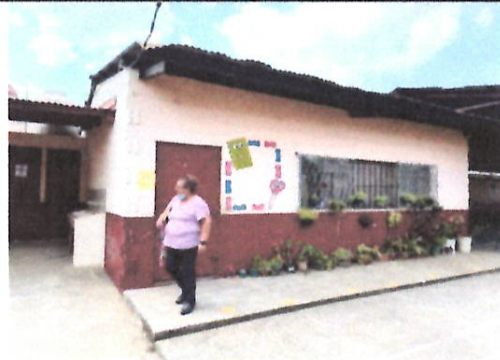
Foto 8: Vista exterior del salón de párvulos en el cual se puede apreciar que las láminas presentan deformación.
