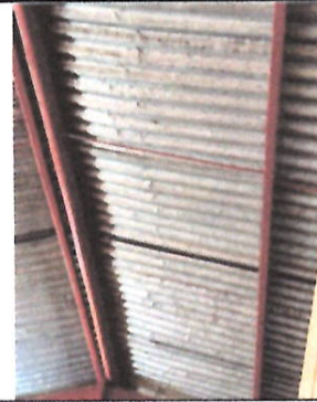
Foto 4: Se aprecia el daño al techo de la cocina y presentan grietas que significan problemas de filtración.
