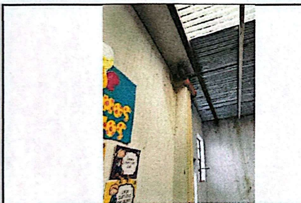
Foto 3: Debido a las malas prácticas al momento de la instalación del techo el canal y las bajadas pluviales se tienen problemas de filtración.
