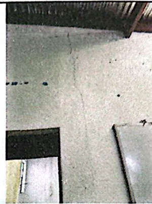
Foto 2: Actualmente el muro presenta fisuras
