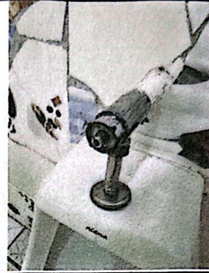
Foto 8: Los mingitorios no cuentan con llaves de tipo push en funcionamiento.
