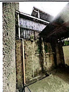
Foto 6: Se tienen problemas de humedad debido a la falta de techo y canal pluvial
