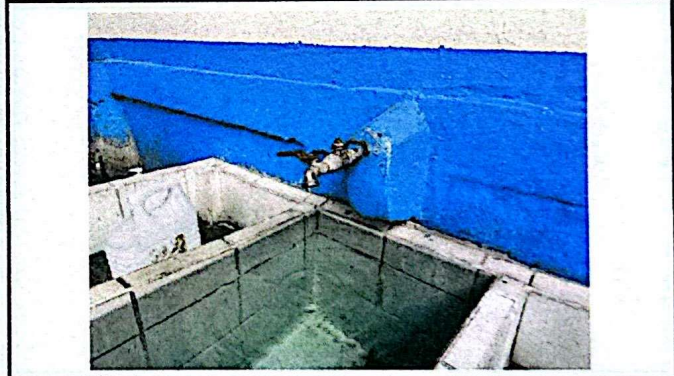
Foto 10: Los chorros pertenecientes a las pilas se encuentran en malas condiciones.
