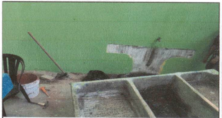
CAMBIO DE PILA
