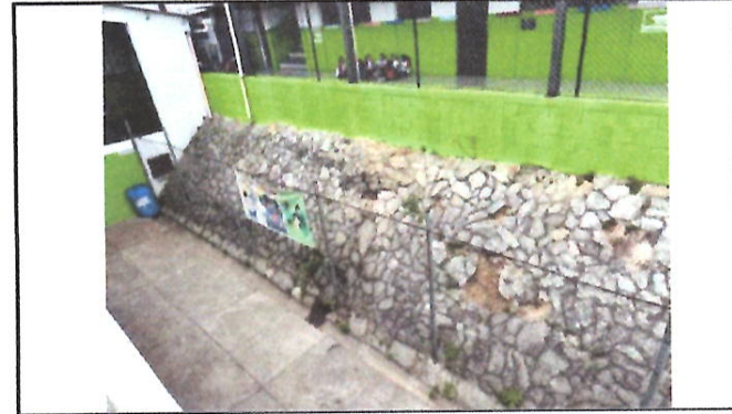
Foto 4: Será necesario realizar el mantenimiento para evitar problemas de erosión.
