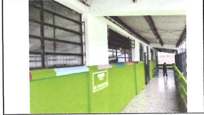
Foto 2: Las ventanas han perdido la capacidad de apertura, debido al óxido por lo que resulta complicado ventilar los salones.
