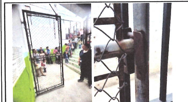
Foto 5: La puerta secundaria no cuenta con chapa y su estructura se encuentra dañada por la corrosión
