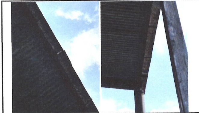
Foto 1: El canal pluvial se encuentra picado debido a la oxidación, las columnas de estructura metálica presentan problemas de corrosión
