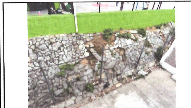
Foto 3: La piedra que recubre el Talud natural del terreno presenta desprendimiento.
