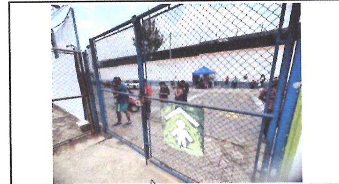
Foto 6: La puerta principal de acceso está dañada debido a la antigüedad.
