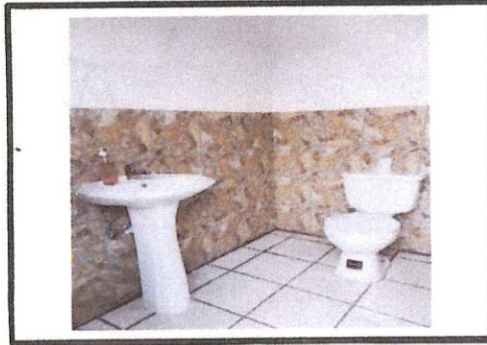
Foto 3: BAÑO TERMINADO, CON SU PISO CERÁMICO NUEVO Y EL INODORO NUEVO A NIVEL DE LOS NIÑOS PEQUEÑOS DE CUATRO AÑOS, DEL MÓDULO "C".
