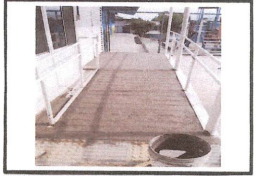
Foto 2: DESMONTAJE DE DUELAS E INICIO DE FUNDICIÓN DE RANPA EN EL AULA PREFABRICADA.
