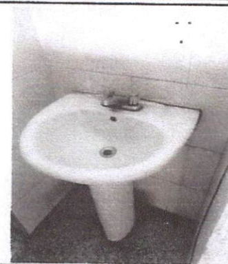
Foto 26: Los lavamanos del Módulo A - Planta Baja, serán reemplazados por nuevos, en la actualidad se encuentran deteriorados y sufren de obstrucción en el sifón.
