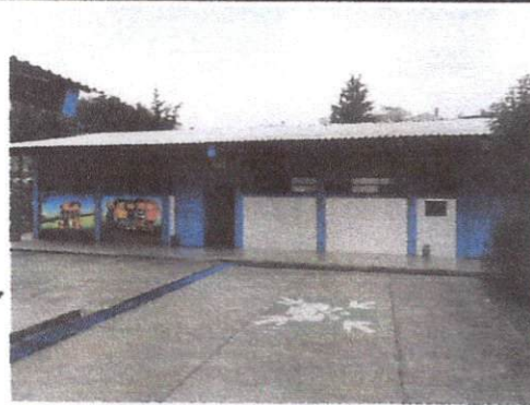
Foto 14: Primera parte del Módulo B - Planta Baja. Serán reparado los bordillos del pasillo.
