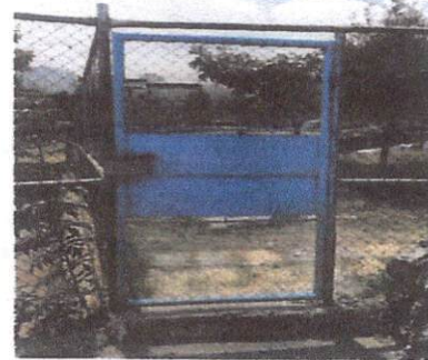
Foto 8: Esta puerta será reemplazada, en su cambio se instalará una puerta formal de metal con techo.
