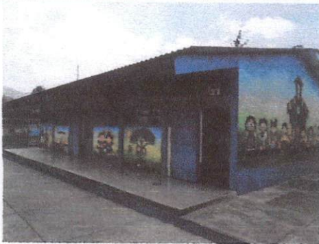
Foto 13: Módulo A - Planta baja. Serán reparados los bordillos del pasillo.
