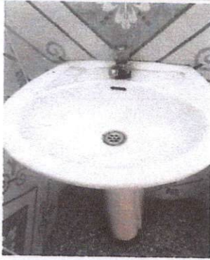
Foto 25: Los lavamanos del Módulo B - Planta Baja, serán reemplazados por encontrarse en mal estado, así mismo el grifo es poco funcional.
