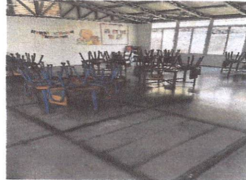
Foto 2: Se llevará a cabo todo el levantamiento de duelas en mal estado y se fundirá 62 metros cuadrados de piso en el aula, se colocará piso cerámico.
