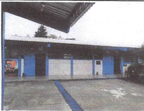
Foto 15: Segunda Parte del Módulo B - Planta Baja. Serán reparados los bordillos del pasillo.
