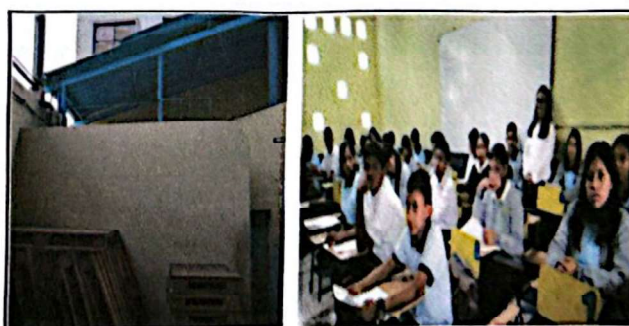
Foto 6: Se necesita remodelar el acceso al segundo nivel, cambiando las gradas que se encuentran detrás de esta pared y construir las pegadas a la pared lateral, esto facilitará la fluidez del alumnado, se necesita quitar los block de vidrio y colocar rejillas en la fila pegada al techo para lograr ventilación.
