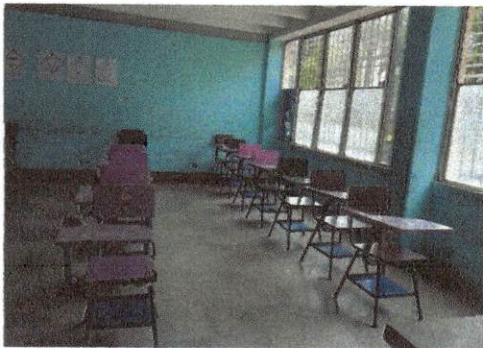
Foto 5: Salon pendiente de pintura
