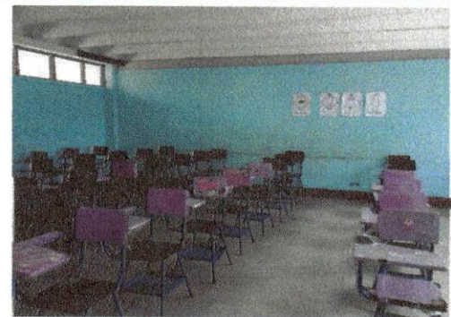
Foto 6: Salon pendiente de instalación eléctrica.
