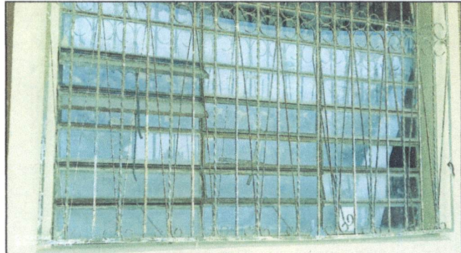
Foto 20: Mantenimiento de un balcón en la clase de segundo primaria con medida de 6 metros cuadrados y un balcón en la bodega vespertina con cuatro metros cuadrados en la planta baja. Lijado, cepillado, aplicación de pintura anticorrosiva, soldar piezas de adorno sueltas.
