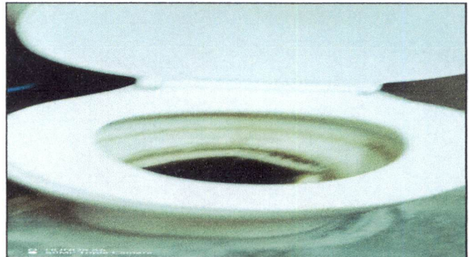
Foto 38: Quitar 6 sanitarios en mal estado (2 en baños de niños y 3 en baños de niñas).
