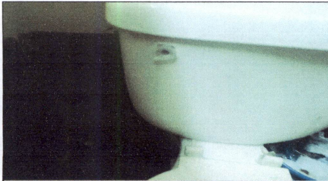
Foto 37: Quitar 6 sanitarios en mal estado (2 en baños de niños y 3 en baños de niñas).
