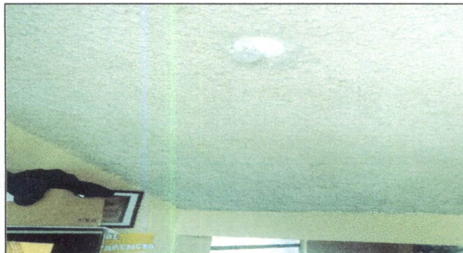
Foto 57: Cambio de 5 focos tipo led de 12 watts (2 en el segundo pasillo frente a segunda primaria, 2 en dirección y 1 en preparatoria).
