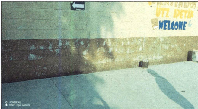
Foto 27: pintar el sócalo en baños de niños, niñas, baño de preparatoria, cocina y en muro perimetral con pintura impermeabilizante.
