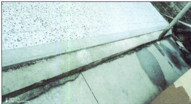
Foto 51: Reparación de plancha de concreto de patio al lado de la cocina dejando un desnivel para que no se acumule el agua y quitar cimiento de concreto de un tubo de agua de canales que no deja fluir de agua.
