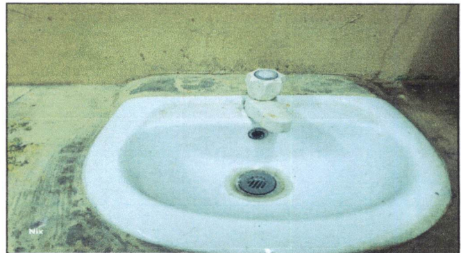
Foto 40: Quitar 4 lavamanos en mal estado (dos de los baños de niños y dos de los baños de niñas) comprar 4 lavamanos nuevos con sus accesorios e instalación de los nuevos lavamanos con tubería y drenaje
