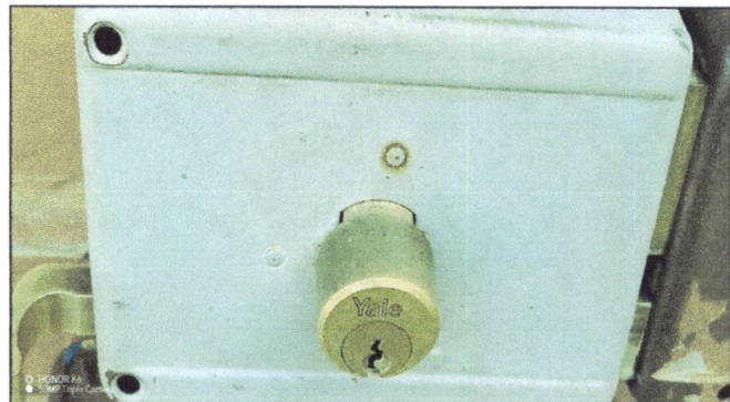
Foto 16: Cambio de chapa Yale a puerta de quinto primaria por mal estado.
