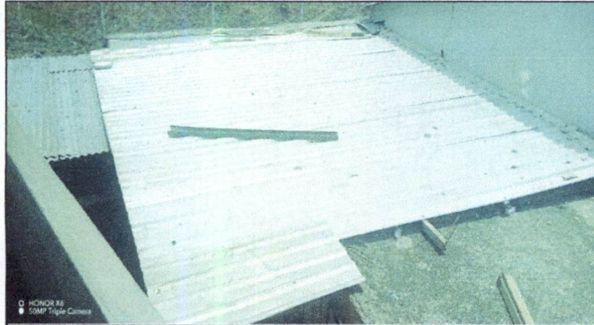
Foto 1: Desmontar el techo completo de lámina de la cocina, compra e instalación de 8 láminas de 18 pies calibre 26 troquelada Aluzinc en techo de cocina
