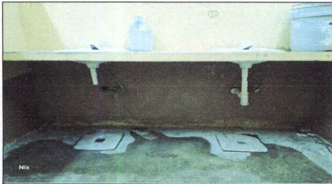
Foto 39: Quitar 4 lavamanos en mal estado (dos de los baños de niños y dos de los baños de niñas) comprar 4 lavamanos nuevos con sus accesorios e instalación de los nuevos lavamanos con tubería y drenaje.
