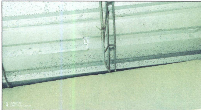
Foto 3: Sustitución y compra de 4 láminas de 10 pies calibre 26 troquelada Aluzinc, una en techo del pasillo de gradas segundo nivel, una en pasillo del segundo nivel, frente al aula de quinto primaria, una por dentro de las
