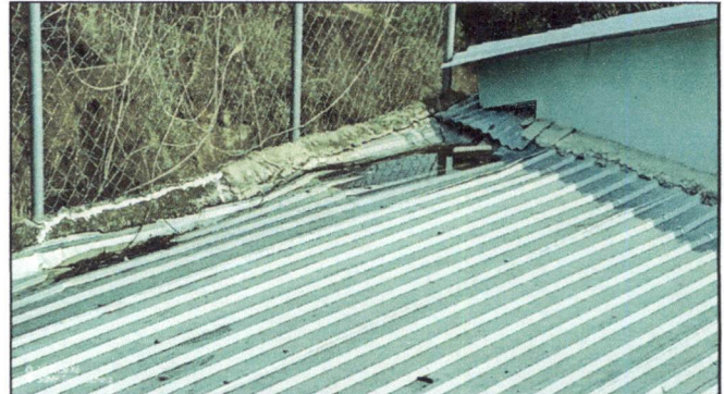
Foto 2: Desmontar el techo completo de lámina de la cocina, compra e instalación de 8 láminas de 18 pies calibre 26 troquelada Aluzinc en techo de cocina
