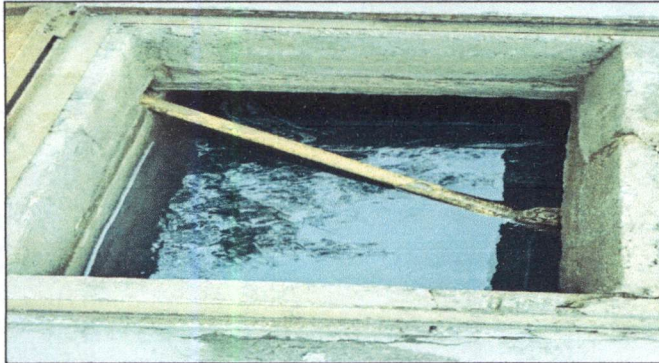
Foto 61: Limpieza y pintar con impermeabilizante la superficie de la cisterna de concreto en el patio con medida de 4x3.6mts y colocación de flote.
