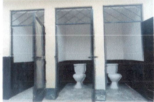
Foto 14: SERVICIOS SANITARIOS Y SUS ACCESORIOS
