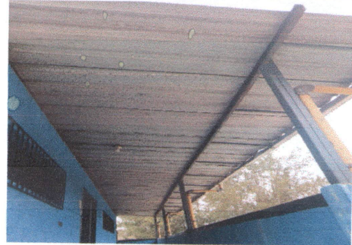
Foto 2: PASILLO DEL TECHO DEL SEGUNDO NIVEL AUN NO SE A CAMBIADO
