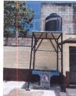
Foto 10: Estructura de Metal para cargar un tinaco de 1100 litros.
