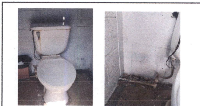
Foto 3: Inodoro que debe sustituirse, debido a su mal estado. (Panorama exterior sanitario).
