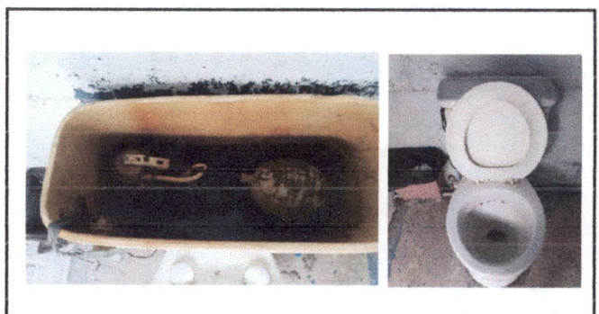
Foto 4: Inodoro que debe sustituirse, debido a su mal estado. (Panorama interior sanitario).
