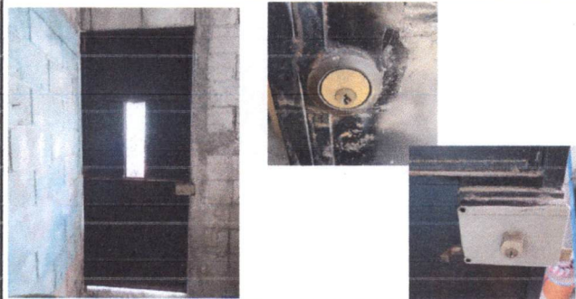
Foto 6: PUERTA SALÓN 3 - (Ángulo norte) - CHAPA de puerta 3, no sirve.
