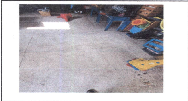
Foto 3: Torta de cemento, Salón 3. (Este salón presenta levantamiento en su estructura). (Ángulo centro del salón)
