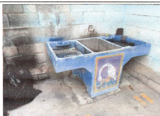
Foto 12: Se observa pila en mal estado
