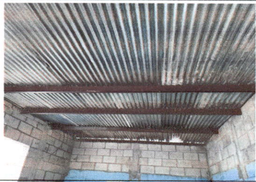
Foto 6: Modulo 2, se observa el mal estado de la lamina y la estructura de soporte necesita mantenimiento
