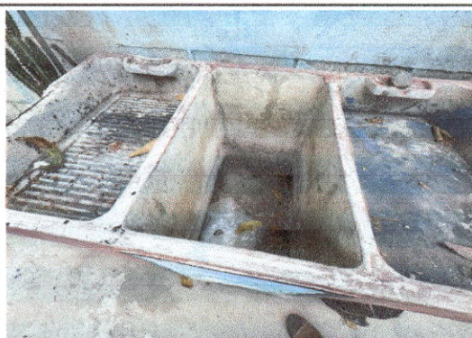
Foto 11: Se observa pila en mal estado
