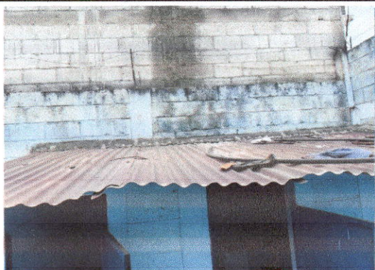
Foto 9: Modulo de Baños, se observa el mal estado de la estructura de soporte y lamina
