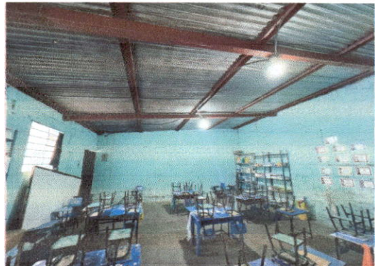
Foto 4: Modulo 1, se observa el mal estado de la lamina y la estructura de soporte necesita mantenimiento
