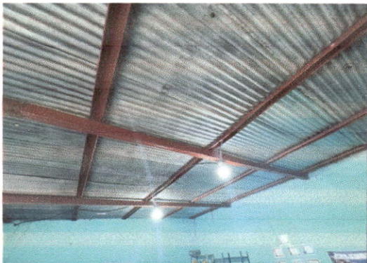
Foto 3: Modulo 1, Se observa el mal estado de la lamina y la estructura de soporte necesita mantenimiento
