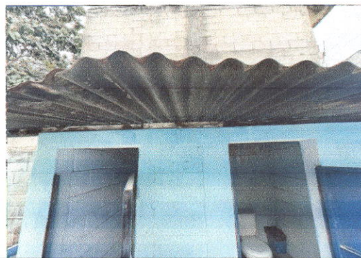
Foto 8: Modulo de Baños, se observa el mal estado de la estructura de soporte y lamina
