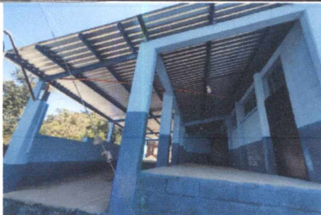
FOTO 5: SUSTITUCIÓN DE CUBIERTA DE LÁMINA, MANTENIMIENTO DE ESTRUCTURA DE SOPORTE DE METAL Y APLICACIÓN DE PINTURA EN MUROS
