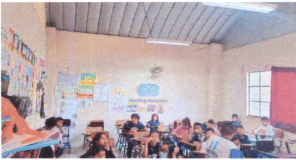
Foto 13: pintura en el interior de salon de clases, planta baja modulo de primaria. No. 9
