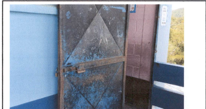
Fotografía 10: Imagen que muestra el estado actual de las puertas con necesidades básicas de pintura.
