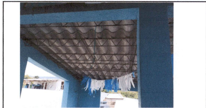
Fotografía 4: Imagen que muestra el estado actual de la estructura portante del módulo de gradas.
