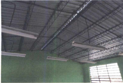
FOTO 1: SUSTITUCIÓN DE LÁMINA POR LÁMINA TROQUELADA Y MANTENIMIENTO A ESTRUCTURA DE SOPORTE DE METAL EN AULAS
