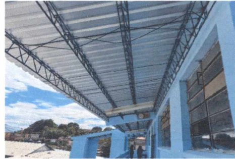
FOTO 4: SUSTITUCIÓN DE LÁMINA POR LÁMINA TROQUELADA Y MANTENIMIENTO A ESTRUCTURA DE SOPORTE DE METAL EN CORREDOR, Y APLICACIÓN DE PINTURA EN MUROS
