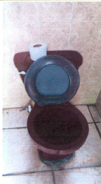
Foto 5: REGÓN 10; SUSTITUCIÓN DE ACCESORIOS INODORO (CONTRA LLAVE, TUBO DE ABASTO Y TANQUE)
