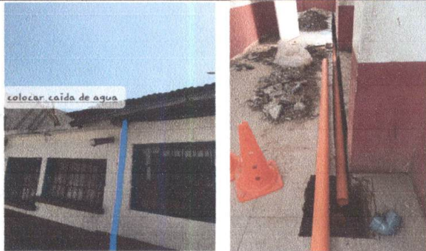
Foto 5: caída de agua en proceso , colocacion de cajas de agua fluvial terminado.
