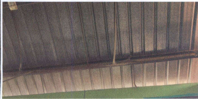
Foto 1: Se realizará la reparación del sistema eléctrico ya que esta deteriorado por antigüedad
