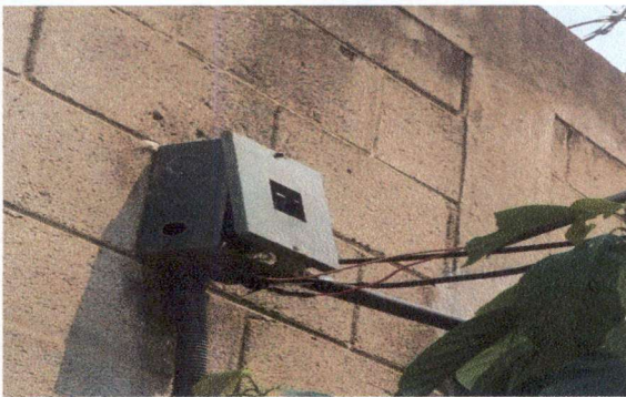
Foto 3: sustitución de tablero de flipones, están ubicados a la interperie y necesitan colocarse modernos para su mejor funcionamiento.
