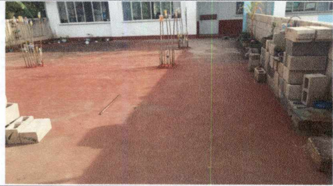
Foto 1: Reparación de grietas en techo de losa por filtraciones, Primera parte de la terraza
