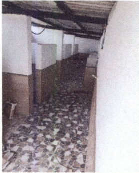
Foto 1: Colocación de piso a un metro de altura en la pared interior de los baños de niños.
