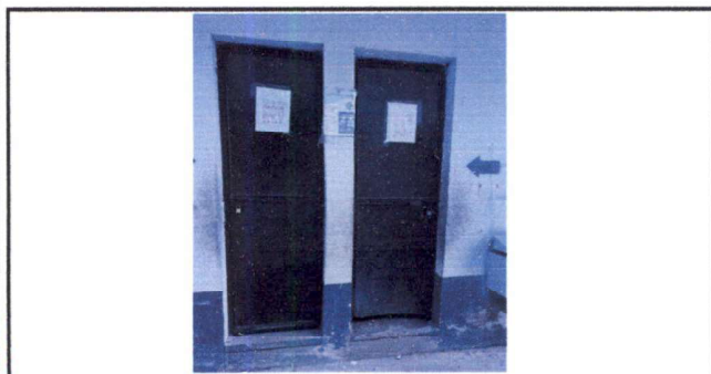
Foto 5: Sustitución de puerta de acceso a servicios sanitarios de niños y niñas del área del anexo.
