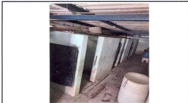
Foto 3: Sanitarios de niñas, sin accesorios y algunos en mal estado. Se propone cambiar los que estan en mal estado y darle mantenimiento a las puertas, colocar piso y azulejo a un metro de alto
