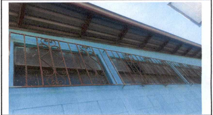
Foto 8: 5.1 Mejoramiento a estructura de metal de ventana que incluye lijado, cepillado y aplicación de pintura anticorrosiva con medidas de 2.30 m de ancho por 1.80 metros de alto en aulas.
