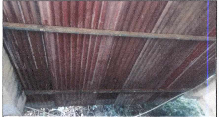
Foto 2: 2.3 SUSTITUCIÓN DE ESTRUCTURA DE SOPORTE DE METAL POR METAL QUE INCLUYE INSTALACIÓN DE ESTRUCTURA METÁLICA ELABORADA CON TUBO METÁLICO 2x2 HN CHAPA 16
