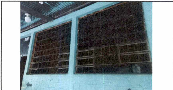
Foto 5: 5.1 Mejoramiento a estructura de metal de ventana que incluye lijado, cepillado y aplicación de pintura anticorrosiva con medias de 1.60 m de ancho por 1.60 metros de alto en cocina cambiando también la orientación de corrediza a orientación abatible
