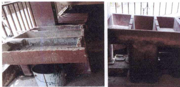
Foto : 19. MANO DE OBRA ESPECIALIZADA EN ( ALBAÑILERIA, ELECTRICIDAD HERRERIA Y PLOMERIA)/ 19.20 Instalacion de pilas.
