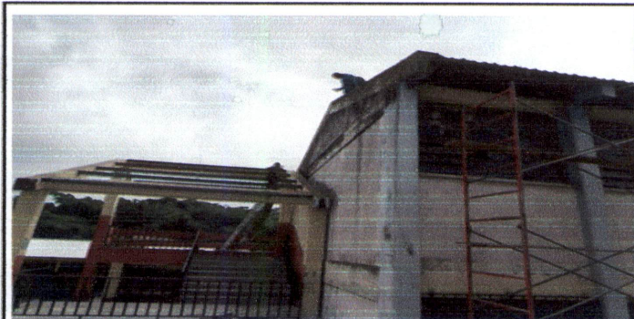
Foto 3: EXTERIOR DE CORREDOR DE LAMINA ALUZINK TROQUELADA CALIBRE 26
