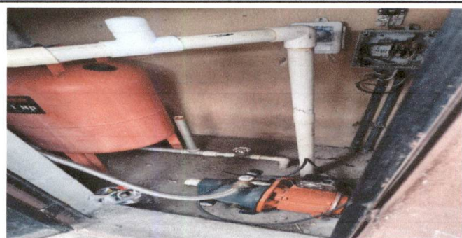
Foto 5: BOMBA DE AGUA
