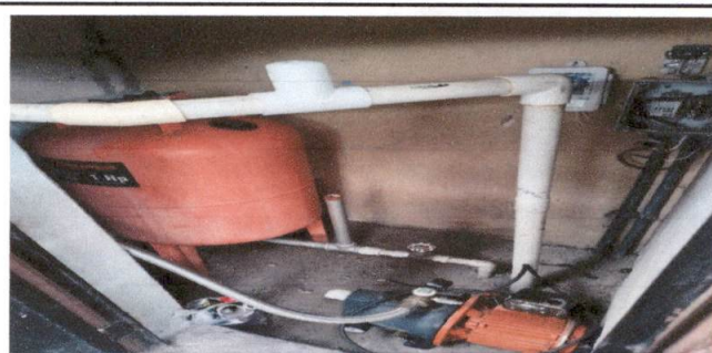
Foto 6: BOMBA DE AGUA
