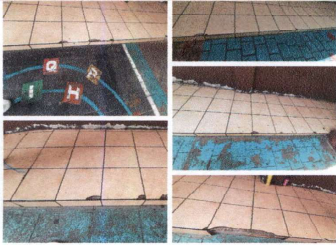
FOTO 7: SUSTITUCIÓN DE PISO CERÁMICO ANTIDESLIZANTE QUEBRADOS Y EN MAL ESTADO EN CORREDOR DE PATIO.
