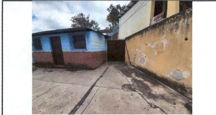
FOTO 1: REUBICACIÓN DE PUERTA DE INGRESO A UN COSTADO DEL MISMO, INCLUYE INSTALACIÓN DE PUERTA EXISTENTE CON TODOS SUS ACABADOS
