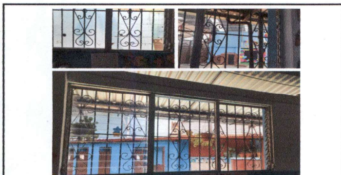
FOTO 5: REPARACIÓN DE VENTANERÍA Y SUSTITUCIÓN POR VENTANAS CORREDIZAS ELABORADAS CON PVC, EN TODO EL MÓDULO DE AULAS
